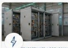
TRAFOSTANICE A ROZVODNY
